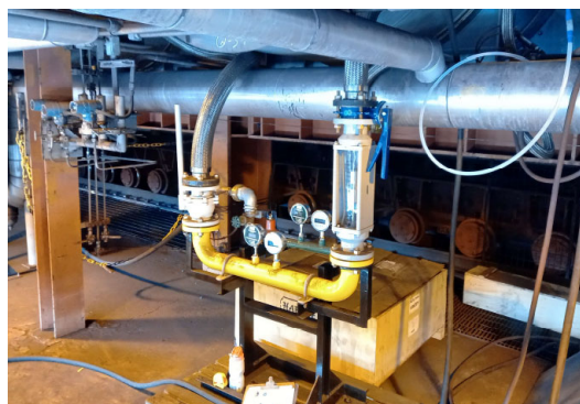
Figura 10. Cavalete auxiliar de medição.
